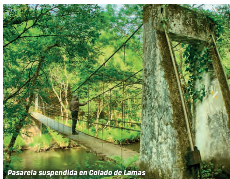
Pasarela suspendida en Colado de Lamas
